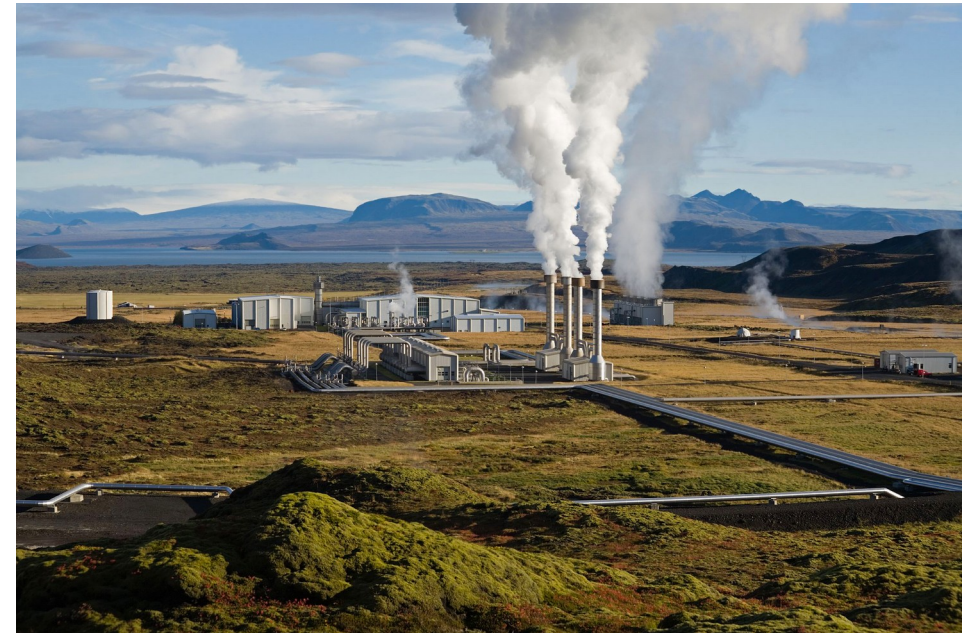
GEO THERMAL PLANT
